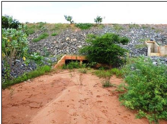
Foto 83 – Passagem de fauna do PMPFN33 (Abr/2017).
