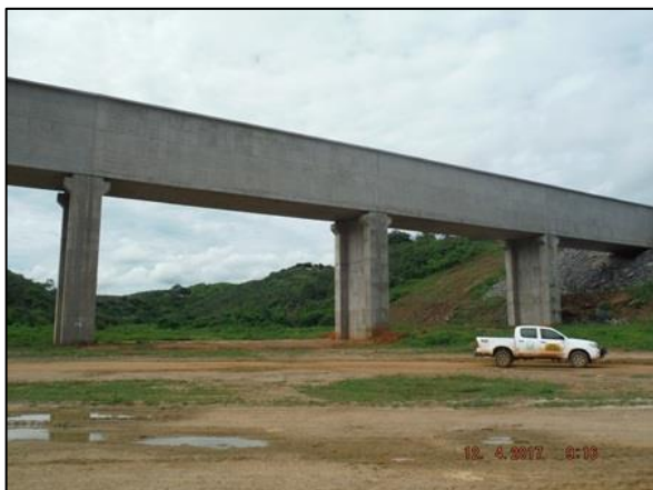
Foto 79 – Passagem de fauna do PMPFN31.
