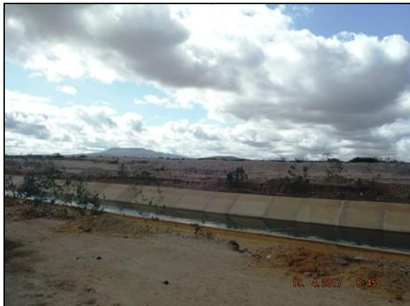
Foto 99 – A estrutura para passagem da fauna não foi construída no local.
