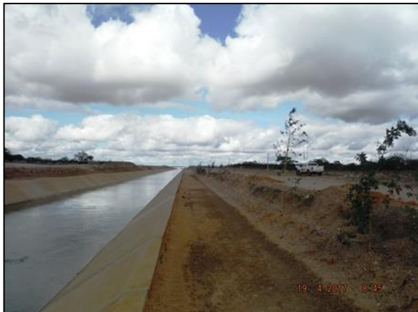
Foto 98 – A estrutura para passagem da fauna não foi construída no local.
