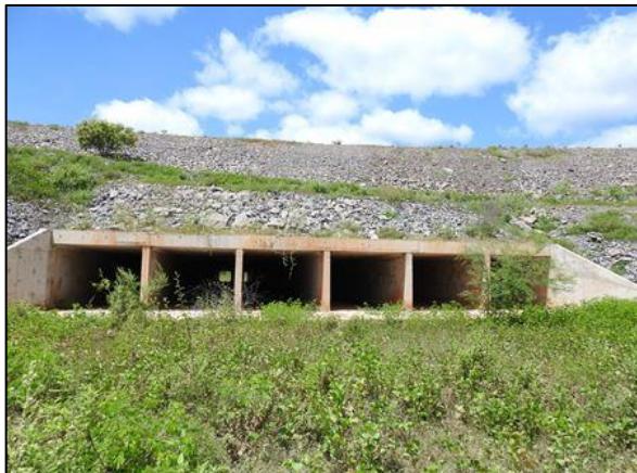
Foto 77 – Passagem de fauna do PMPFN30 (Abr/2017).
