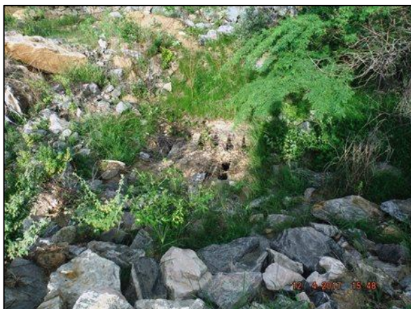
Foto 142 – Abertura do bueiro obstruída e não compatível com uma passagem de fauna.
