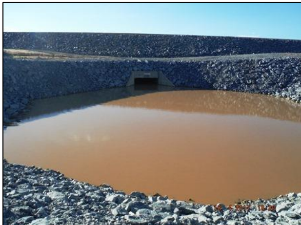
Foto 104 – Passagem de fauna no PMPFL08, obstruída pela água da chuva.
