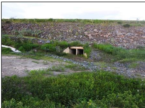
Foto 85 – Passagem de fauna do PMPFN34 (Abr/2017).
