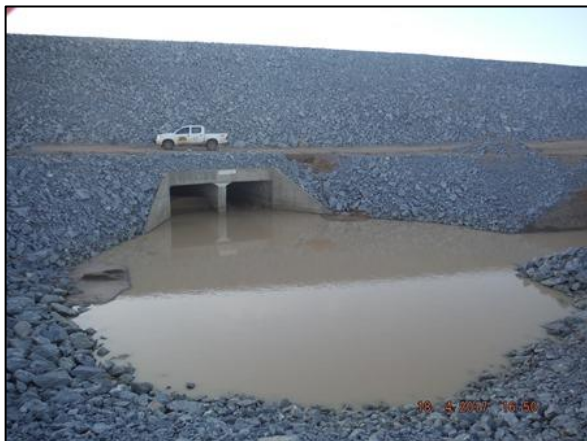
Foto 102 – Passagem de fauna no PMPFL07, parcialmente obstruída pela água da chuva.
