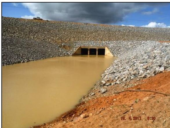
Foto 100 – Passagem de fauna no PMPFL06 parcialmente obstruída pela água da chuva.
