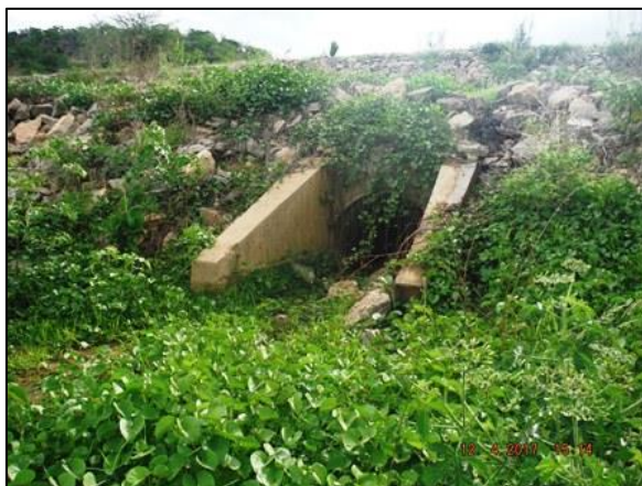
Foto 143 – A estrutura construída não é compatível com uma passagem de fauna.
