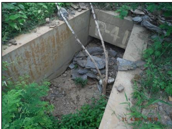
Foto 67 – Passagem de fauna obstruída por sedimento no PMPFN25.
